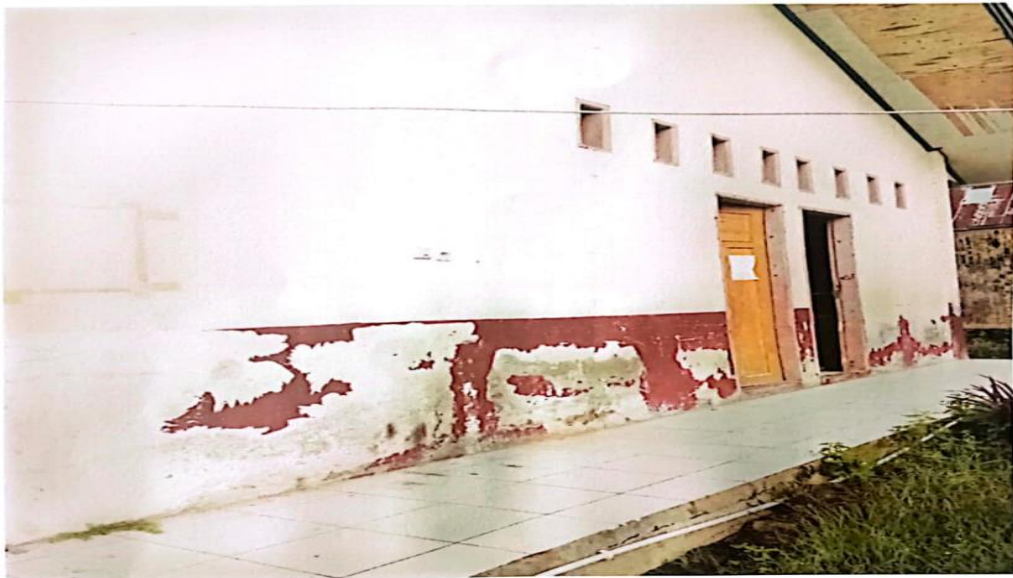
Tampak Kondisi Plafot Yang Sudah Lapuk
