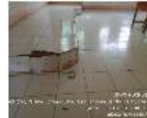
9. TAMPAK LANTAI RUSAK
