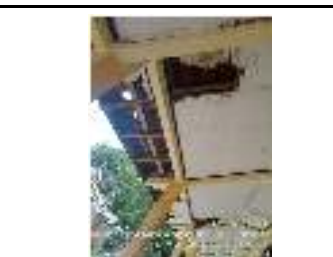
10. TAMPAK PLAFOND RUSAK
